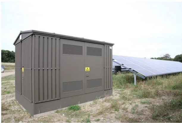
Foto: Eksempel på teknikbygning. Her en typisk fordelingstransformer placeret i en såkaldt transformerkiosk. Der etableres ca. en fordelingstransformer per 3-4 MW installeret solcellekapacitet.
